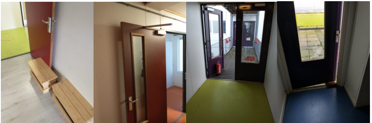
Afbeelding 5.5: brandwerende en zelfsluitende deuren staan open.
